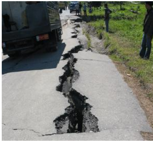
Gambar 9.4 Tanah yang retak akibat gempa
